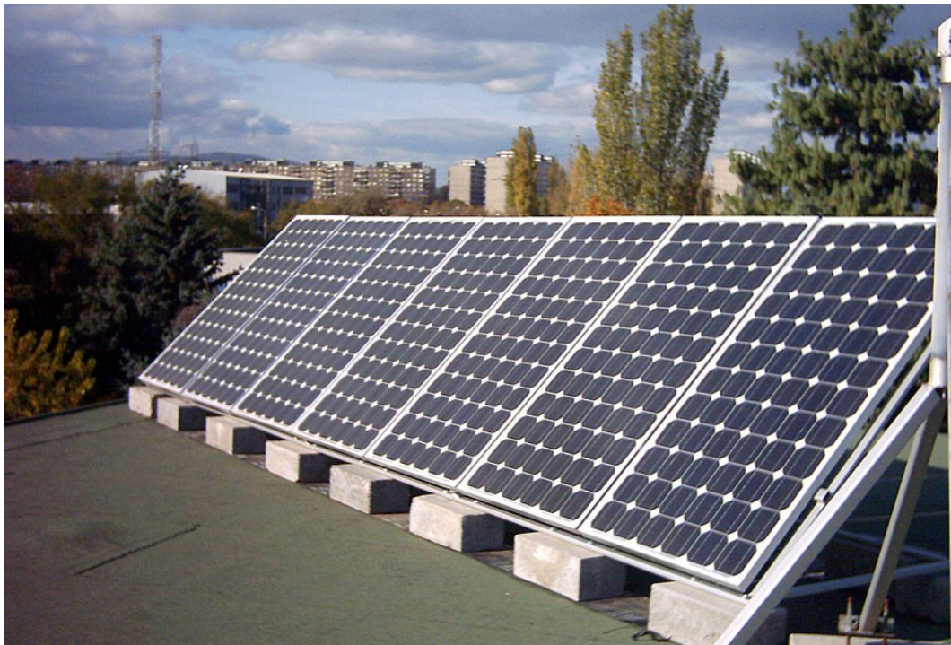
7. ábra: A VHJ Kft. telephelyén a tetőre felszerelt napelemes áramforrás
